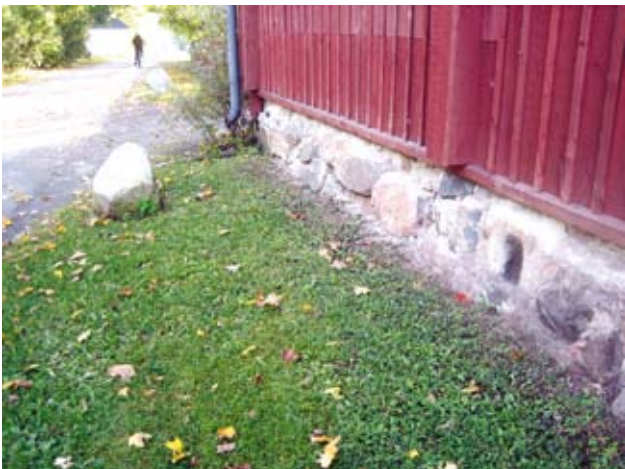
'Historiaa havisevalla' kirkkohistoriallisella tieosuudella voi katsoa myös yksityiskohtia: vanhaa kivijalkaa, seinää. Maarian pappila, Turku.
